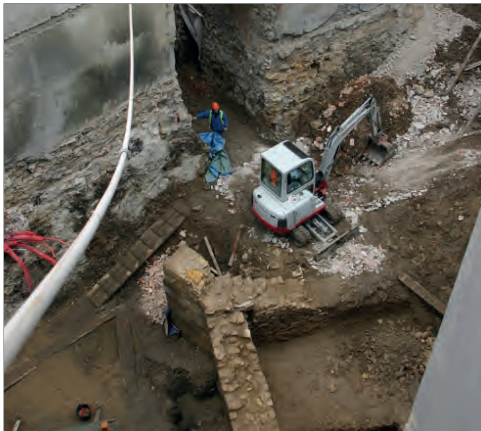
Obr. 4: Praha-Malá Strana, dvůr mezi čp. 28 a 33/III. Nárožní opěrák na JZ rohu východního traktu na ploše J. Opěrák byl vyzděn z lomového opukového kamene, který byl na nárožích zpevněn armovacími pískovcovými kameny. Pohled od S (foto M. Müller, 2007).
